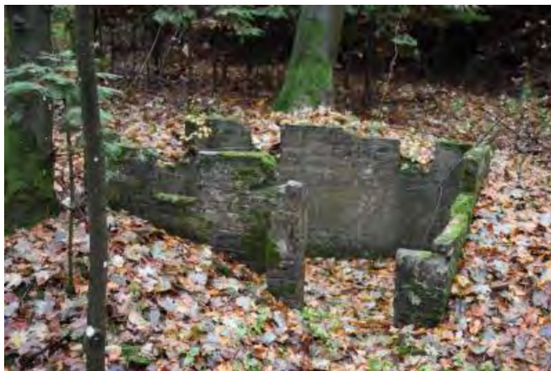
Figur 11: Betonruin i skoven umiddelbart øst for dambruget.
